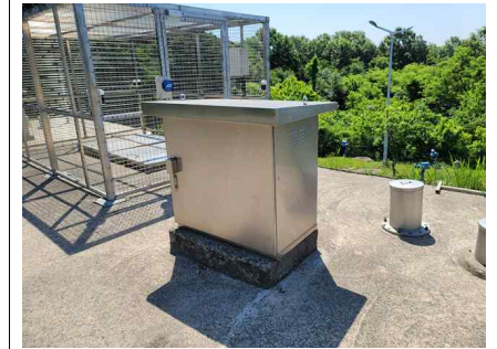
<외부 현장제어반 상태양호>
