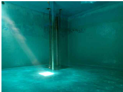
<배수지 1지 전경>
