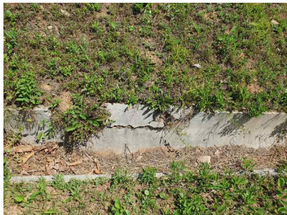
<부대시설 배수지 장내 배수로 파손>
