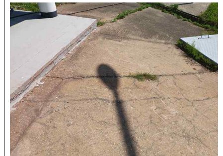
<부대시설 배수지 장내 포장균열>
