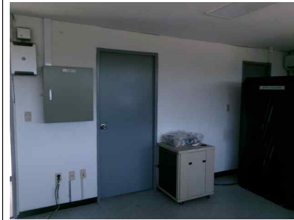
<전력 배전반 및 전기설비 상태양호>
