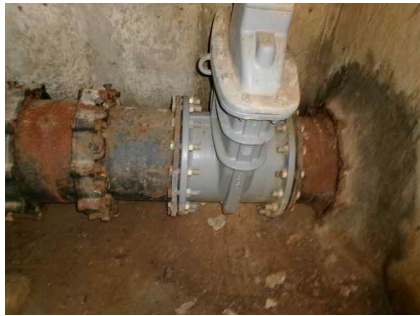
<유입밸브실 유출 밸브, 배관, 볼트류 부식>
