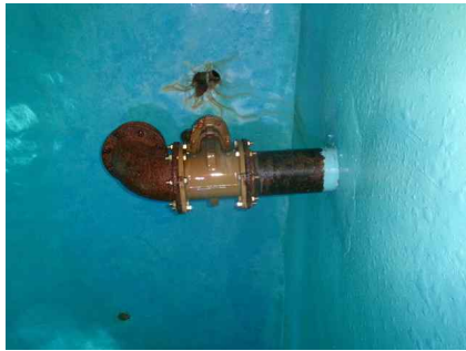
<배수지 1지 유입 배관 차수불량>
