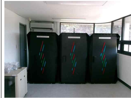
<전기실 전기설비 상태양호>
