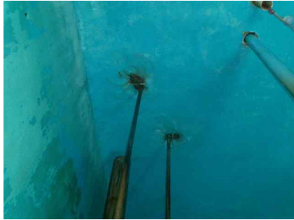
<배수지 1지 상부슬래브 철근노출>
