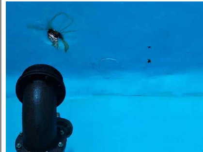
<배수지 2지 상부슬래브 박락>
