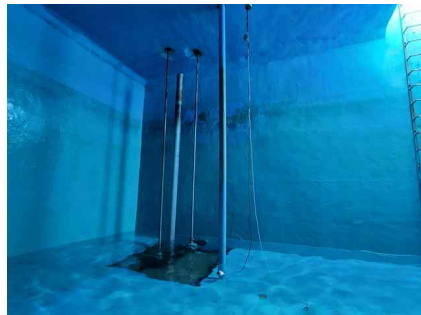
<배수지 2지 전경>
