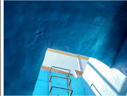
<배수지 2지 상부슬래브 백태>
