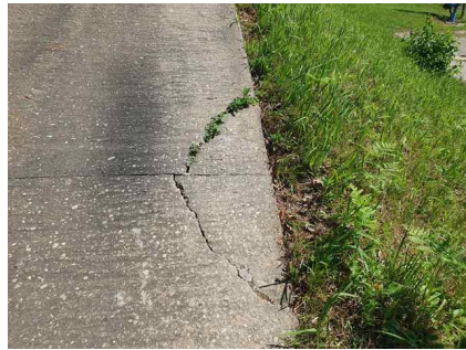
<부대시설 배수지 장내 포장파손>
