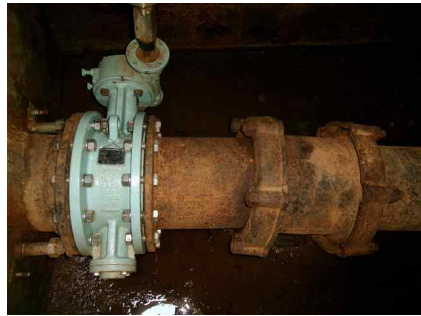
<유입밸브실 유출 밸브, 배관, 볼트류 부식>
