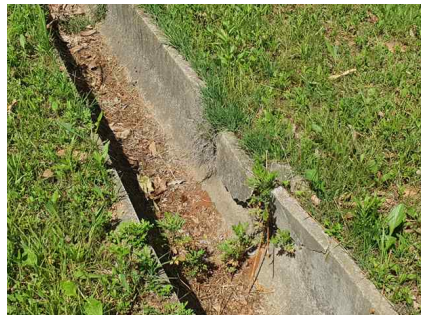
<부대시설 장내 배수로 파손>
