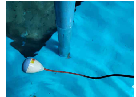
<배수지 2지 바닥슬래브 도장박리>
