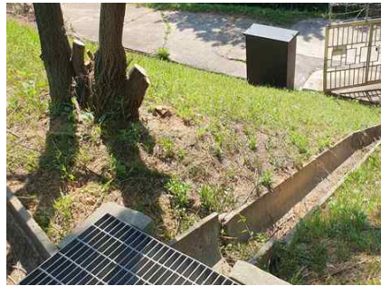
<부대시설 장내 배수지 상부 파손>
