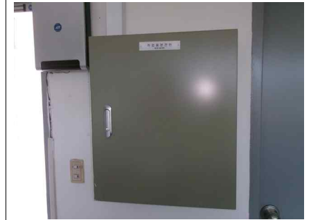
<전기실 작업용분전반 상태양호>
