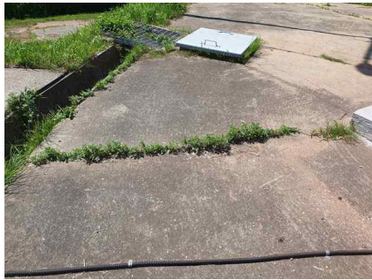
<부대시설 배수지 장내 포장균열>
